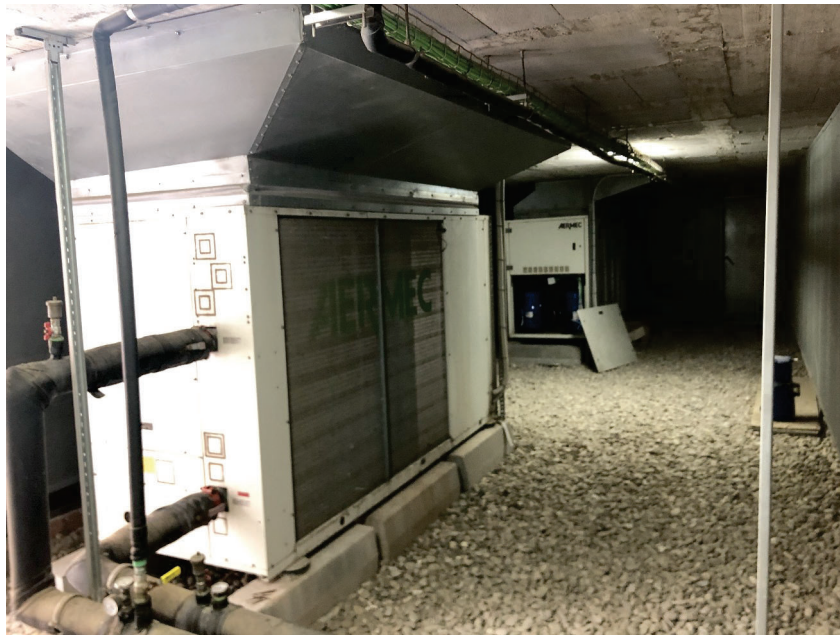
Figura 2: Bombes de calor actuals
