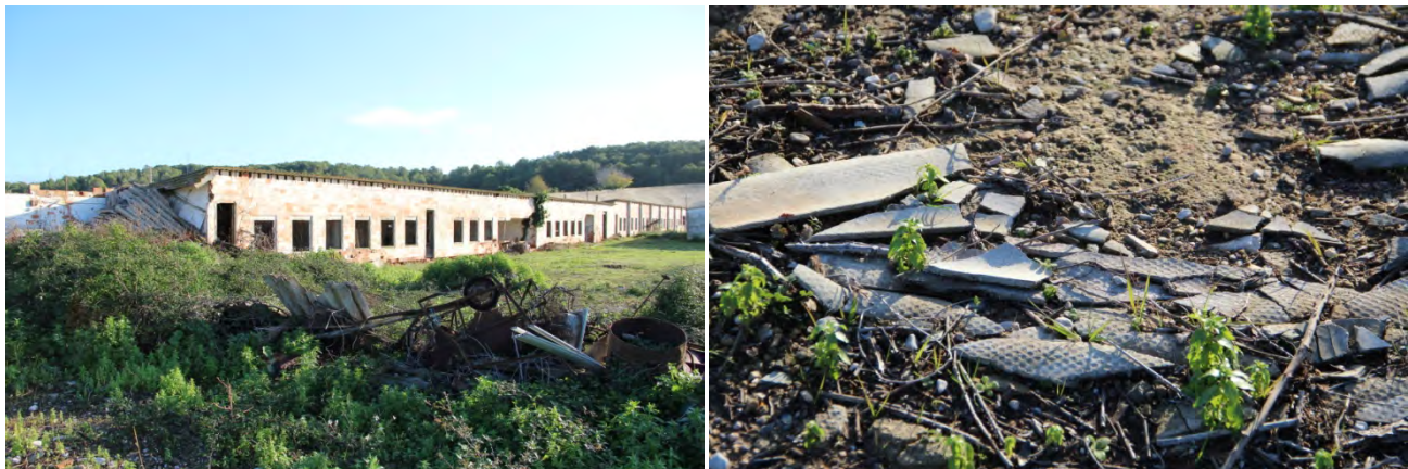
Imatge 51. Presència de residus i restes d'amiant
